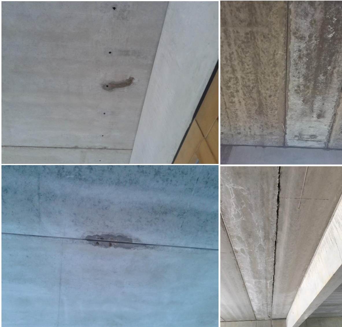
Obr. 2 – spodní líc dílců Spiroll – odvodňovací otvory, rozdíly v jednotnosti barevného tónu, protečení vody spárou, spára mezi doplňkovými šířemi
